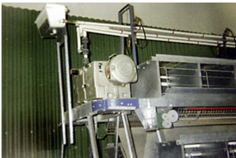
图7.16: 高压喷雾系统。
