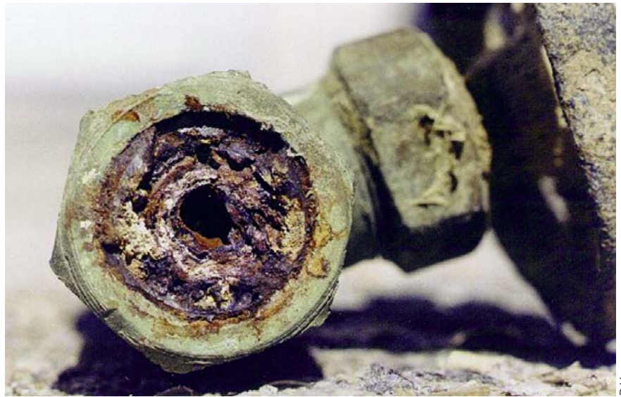
图81.34: 管线上的污垢改变了水流量。
